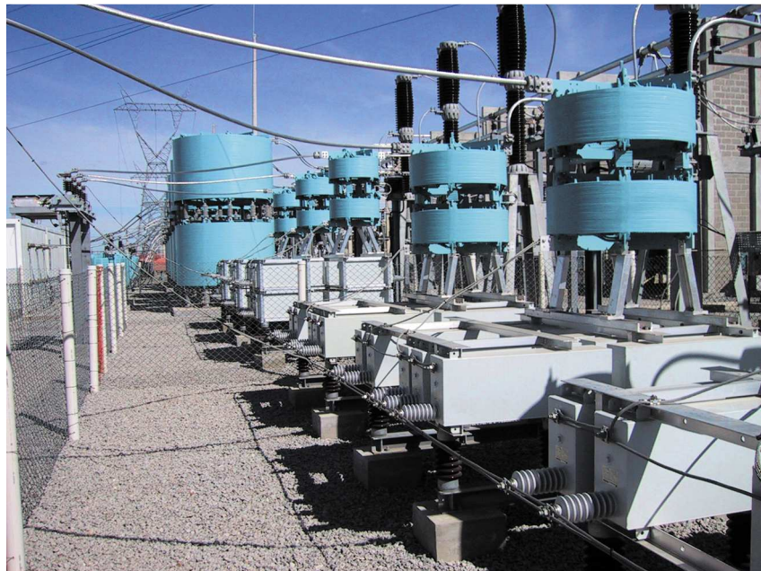
Joonis 1.43 Firma Nokia Capacitors SVC-kompenseerimisseade
